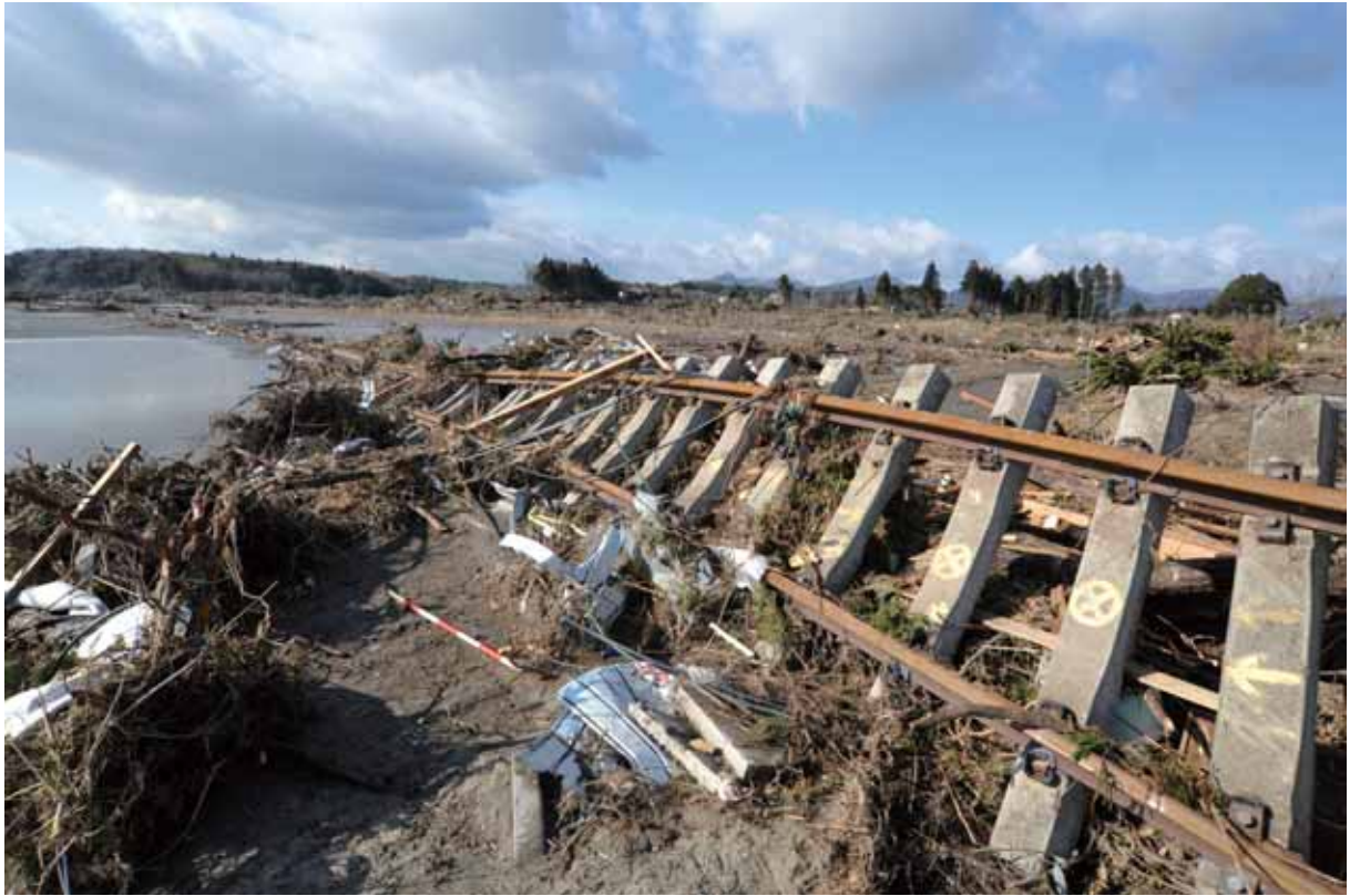
津波によって破壊された線路 (写真提供：菅野哲也氏)
