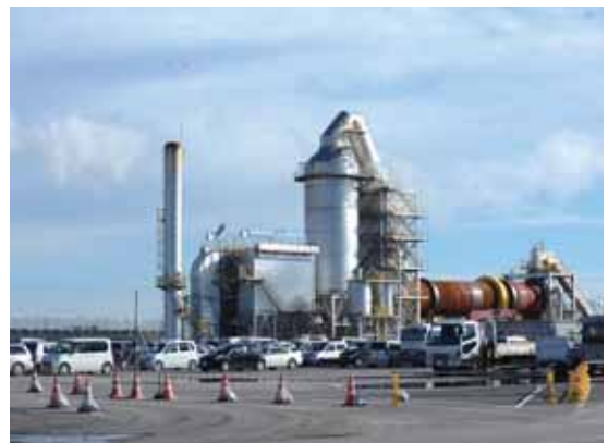
稼働を続けるがれき処理施設
