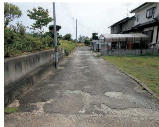
▲舗装の劣化で剥離や凹凸が見られる私道
