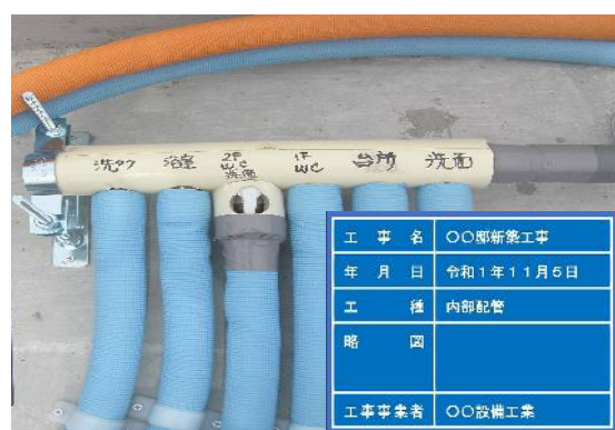
屋内配管状況
