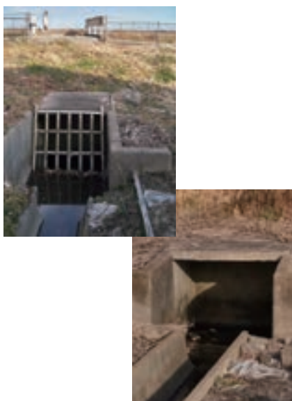
改修を待つ重要排水施設サイホン
