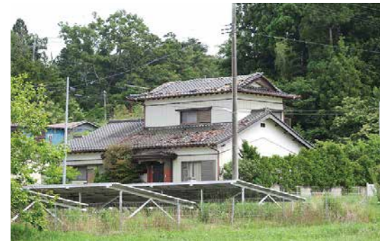
地震により被害を受けた瓦屋根
