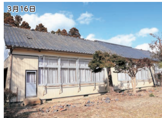
3月16日 福島県沖地震で瓦屋根などに被害を受けた「真庭区民会館」
