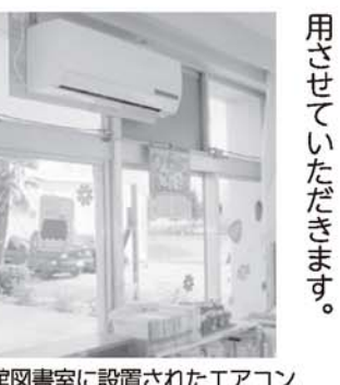
中央公民館図書室に設置されたエアコン
