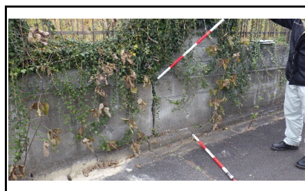
写真10 ブロック積擁壁の目地開き
