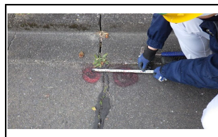
写真11 定点観測3 アスファルトの亀裂
