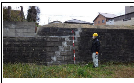
写真13 ブロック積擁壁の目地開き
