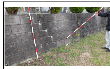
写真8 ブロック積擁壁の目地開き
