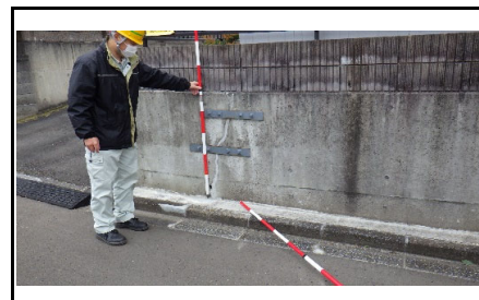
写真7 宅地擁壁の亀裂
