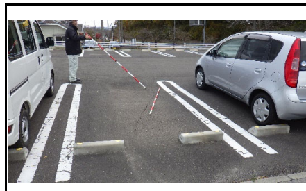
写真2 アスファルトの亀裂
