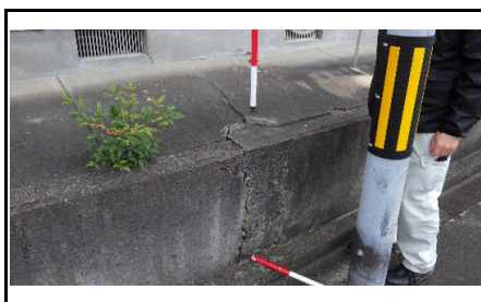
写真9 宅地擁壁の亀裂
