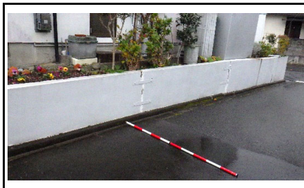
写真5 宅地擁壁に亀裂が生じている
