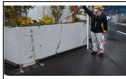
写真7 宅地擁壁に亀裂が生じている
