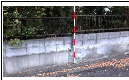
写真2 宅地擁壁に亀裂が生じている
