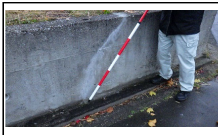
写真14 宅地擁壁に亀裂が生じている
