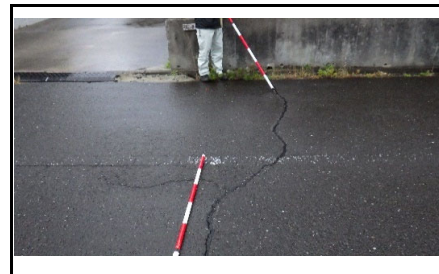
写真11 アスファルトに亀裂が生じている
