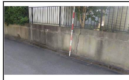
写真3 宅地擁壁に亀裂が生じている
