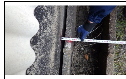
写真8 定点観測3 建物基礎-U字溝の隙間
