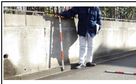
写真1 宅地擁壁に亀裂が生じている
