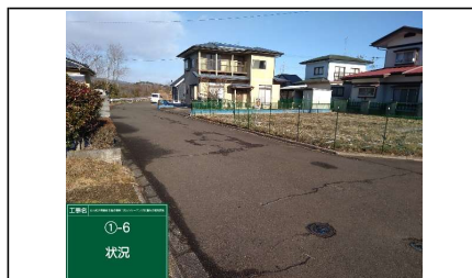
写真⑤ 盛土上端部(道路の亀裂補修跡)
