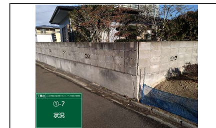
写真④ 盛土上端部(Co擁壁の亀裂)
