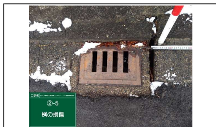
写真⑤ 盛土上端部(雨水枡の損傷)
