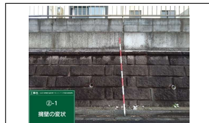
写真② 盛土上端部(ブロック積擁壁、Co擁壁の亀裂)
