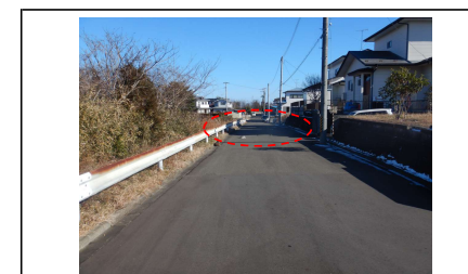
写真⑯ 盛土上端部(道路面の沈下傾向)
