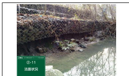
写真⑬ 盛土下端部(排水工の水没の可能性)
