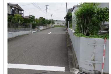
⑳ 路面状況(擁壁に亀裂)
