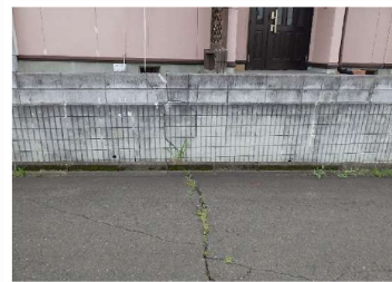
⑧ 宅地擁壁および路面に亀裂
