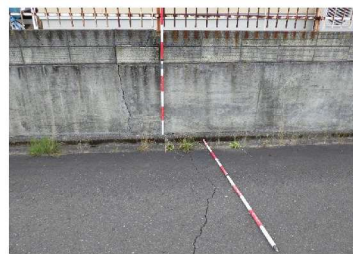
⑫ 宅地擁壁および路面に亀裂
