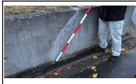
写真14 宅地擁壁に亀裂が生じている
