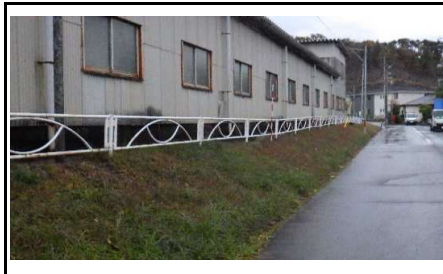
写真9 盛土頭部付近 沈下によりフェンス揺み
