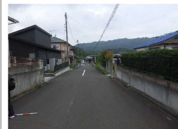
⑭ 沈下による路面変状+擁壁に亀裂
