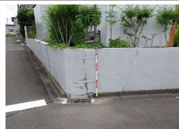
⑱ 宅地擁壁の亀裂(補修済)
