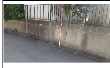
写真3 宅地擁壁に亀裂が生じている
