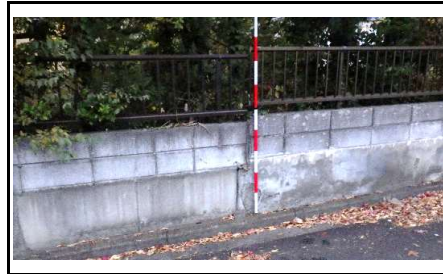
写真2 宅地擁壁に亀裂が生じている
