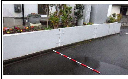
写真5 宅地擁壁に亀裂が生じている
