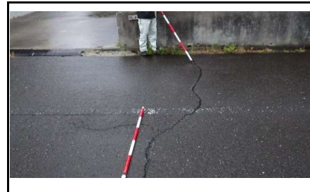
写真11 アスファルトに亀裂が生じている
