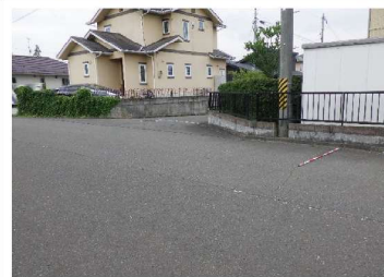
⑬ 盛土境界付近(路面に亀裂)
