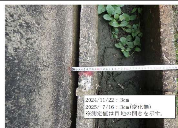
⑰ 定点観測 3 建物基礎-U字溝の隙間
