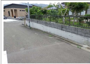
㉑ 宅地擁壁の亀裂(補修済)
