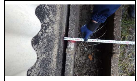
写真8 定点観測3 建物基礎-U字溝の隙間
