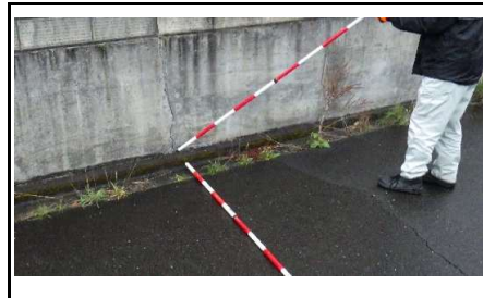
写真10 宅地擁壁、アスファルトに亀裂が生じている
