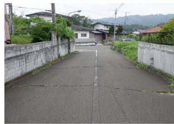
⑦ 路面に亀裂
