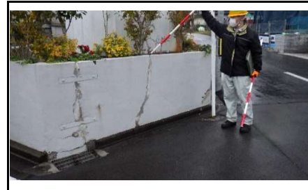
写真7 宅地擁壁に亀裂が生じている
