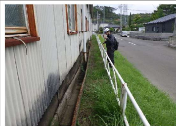
⑯ U字溝の沈下
