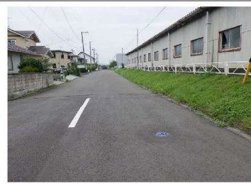
㉓ 盛土上端部(沈下による路面変状)
