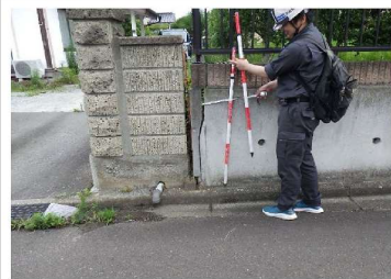
⑪ 宅地擁壁に目地開き
