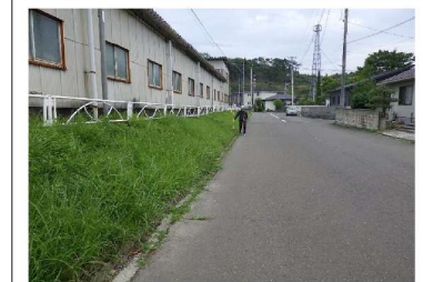
⑮ 盛土上端部(沈下による路面変状)
