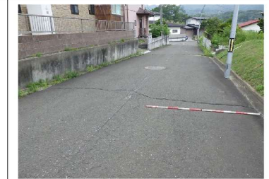
⑩ 路面に亀裂
