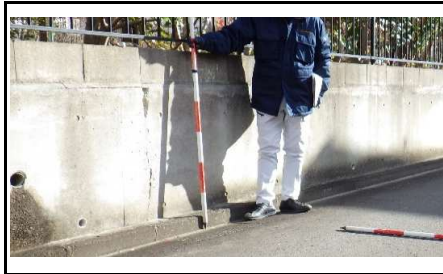
写真1 宅地擁壁に亀裂が生じている
