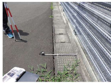
㊦㊧ 定点観測1 U字溝-アスファルトの目地開き
