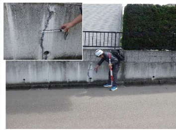
④③ 宅地擁壁の亀裂(1mm程度)
