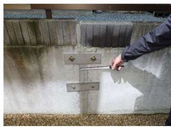
④② 宅地擁壁の目地開き(補修済)
