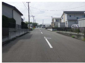
④① 沈下による路面変状
