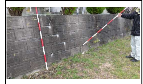
写真8 ブロック積擁壁の目地開き
