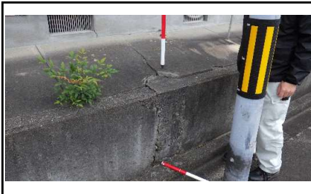
写真9 宅地擁壁の亀裂
