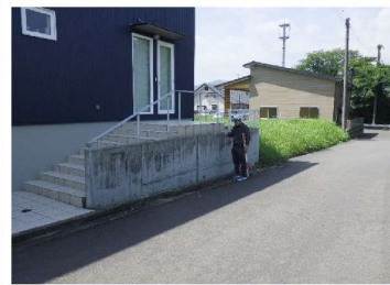
⑧ 擁壁付近の変状(全景)
