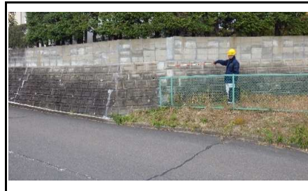
写真14 擁壁の目地開き、アスファルトに亀裂
