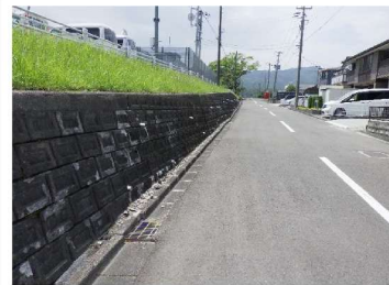
④⑱ 盛土境界付近
