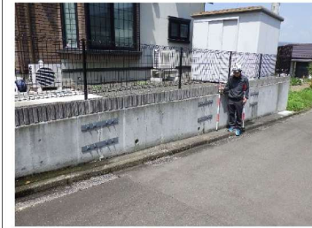
㉞ 宅地擁壁の亀裂(補修済)
