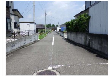
㉟ 沈下による路面変状(擁壁+路面亀裂)
