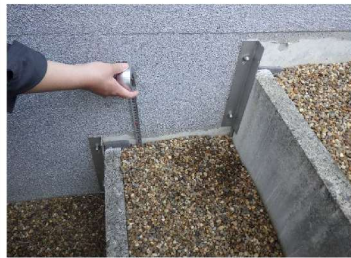
㊿ 建物周辺地盤の沈下(3~8cm程度)
