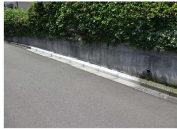
㉛ 宅地擁壁の沈下(補修済)
