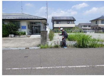
④⑫ 宅地擁壁の亀裂
