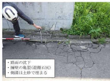
⑦ L型側溝集水マス付近の土砂吸出し
