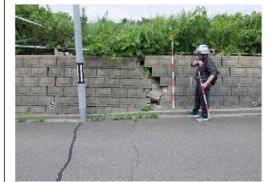
⑩ ブロック積擁壁の目地開き+路面の亀裂
