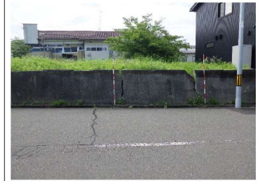
⑮ 宅地擁壁の亀裂(5cm程度)+道路の亀裂
