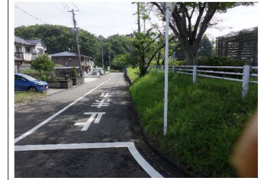
④⑮ 沈下による路面変状
