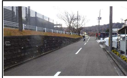
写真6 旧地形の谷筋付近、沈下による擁壁の撓み
