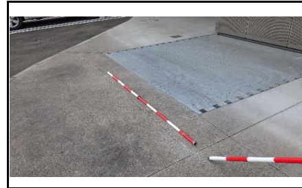
写真3 コンクリートの亀裂
