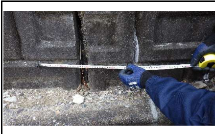
写真5 定点観測2 ブロック積擁壁の目地開き
