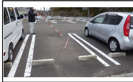
写真2 アスファルトの亀裂
