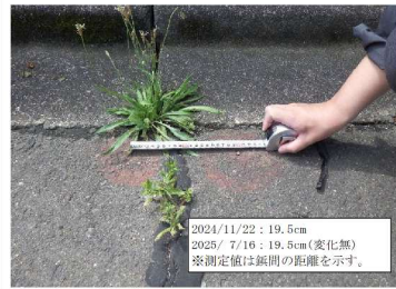
⑯ 定点観測3 アスファルトの亀裂
