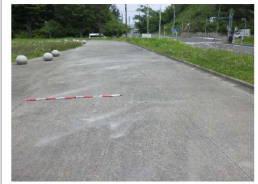
㊦ コンクリートの亀裂
