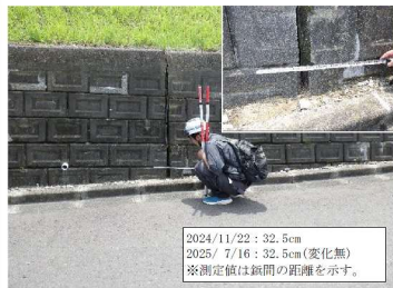
④⑰ 定点観測2 ブロック積擁壁の目地開き
