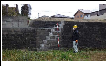
写真13 ブロック積擁壁の目地開き
