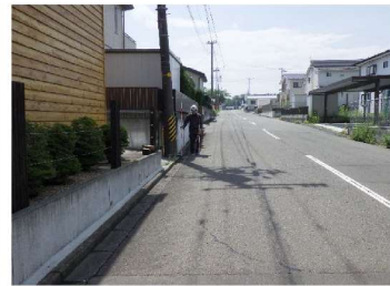
㊿ 沈下による路面変状(電柱傾き+路面亀裂)
