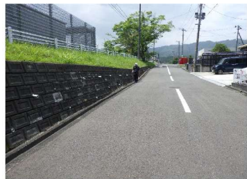
④⑯ 旧地形の谷筋、沈下による擁壁の撓み
