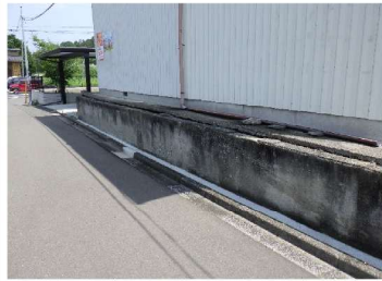
㉜ 宅地擁壁の沈下(補修済)
