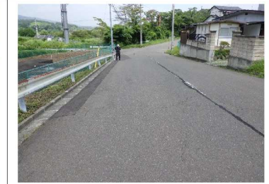
㉕ 路面の亀裂+路肩の変状(補修済)
