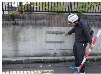
④⑦ 宅地擁壁の亀裂(補修済)
