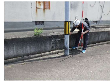
⑲ 宅地擁壁の亀裂
