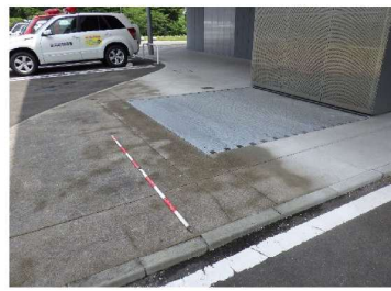
㊦ コンクリートの亀裂
