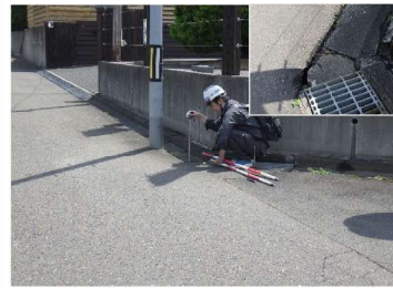
⑱ L型側溝集水マス付近の土砂吸出し
