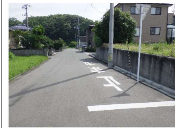
④⑨ 路面および擁壁に変状無し(復旧済)
