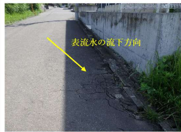
⑥ L型側溝集水マス付近の土砂吸出し
