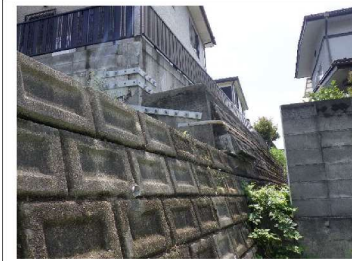
㉔ ブロック積擁壁の変状
