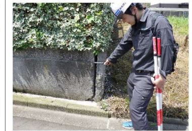
㉚ 宅地擁壁の亀裂
