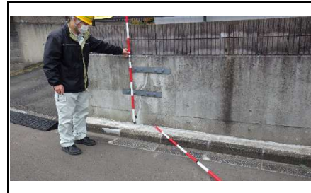
写真7 宅地擁壁の亀裂
