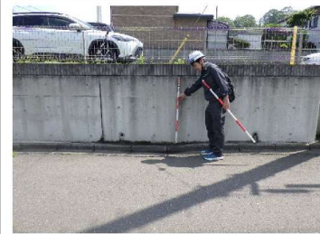
⑨ 沈下による路面変状
