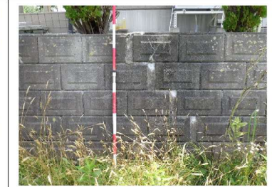
④⑤ ブロック積擁壁の目地開き(補修済)
