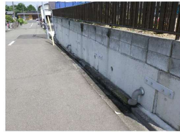
㉝ 宅地擁壁の亀裂(補修済)
