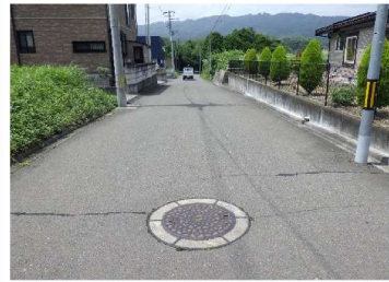
⑪ 盛土境界付近(路面に亀裂)
