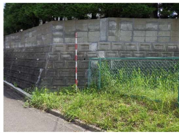
㉒ ブロック積擁壁の目地開き(補修済)
