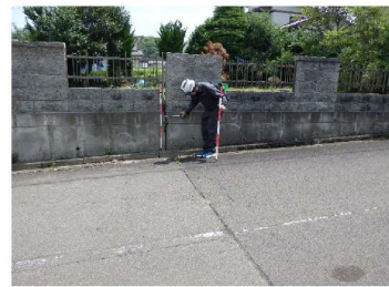
㉘ 擁壁+路面の亀裂
