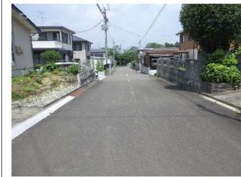
㉙ 沈下による路面変状
