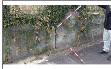
写真10 ブロック積擁壁の目地開き
