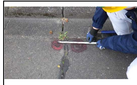
写真11 定点観測3 アスファルトの亀裂
