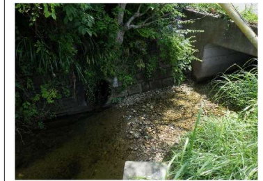
⑳ 盛土末端のり尻部(排水管)
