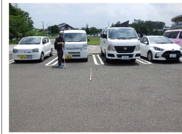
㊦ アスファルトの亀裂
