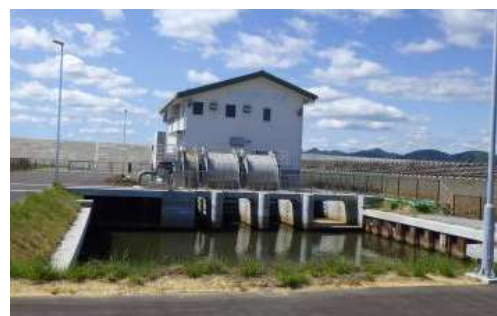
防災機能強化のため新設された排水機場 (戸花川排水機場)
