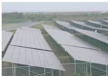
太陽光発電設備
