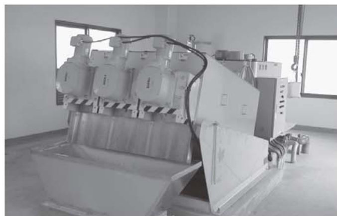
設備棟に設置された汚泥脱水設備
