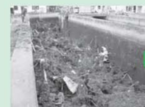
処理槽 被災時
