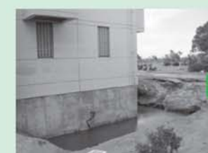
沈砂池棟 被災時
