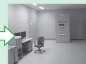
中央監視室 復旧後
