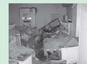
中央監視室 被災時
