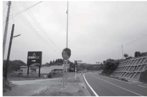
宮城野ゴルフ入口に設置されたLED照明灯
