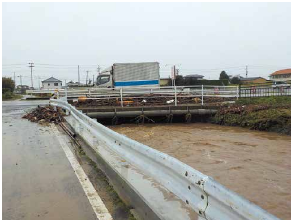
山寺川の流木（越水の原因？）
